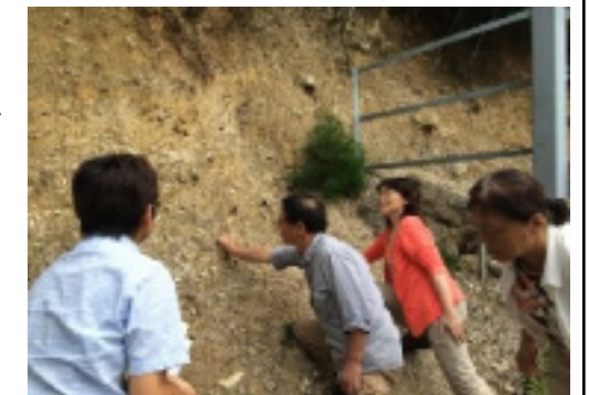
土砂崩れが心配：山肌の土がボロボロと崩れてくる。
